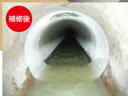
FRP内面補強工法による修繕(本管・取付管一体型施工)
